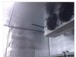
冷藏室内的 隔热盖板
