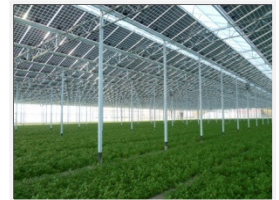
温室太阳能光伏系统
