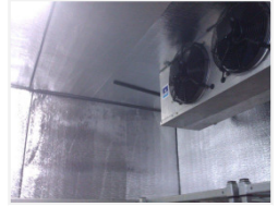
الغلاف المعزول داخل الغرفة الباردة
